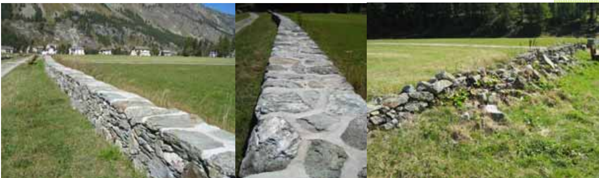
Abbildung 110: Trockensteinmauern im Gebiet Champsegl. Links: Aus ökologischer Sicht sterile Trockensteinmauer. Mitte: Die wertvollen Fugen wurden mit Mörtel verschlossen. Rechts: Zerfallene Trockensteinmauer die repariert werden sollte (Fotos DR, 13.09.2007)
