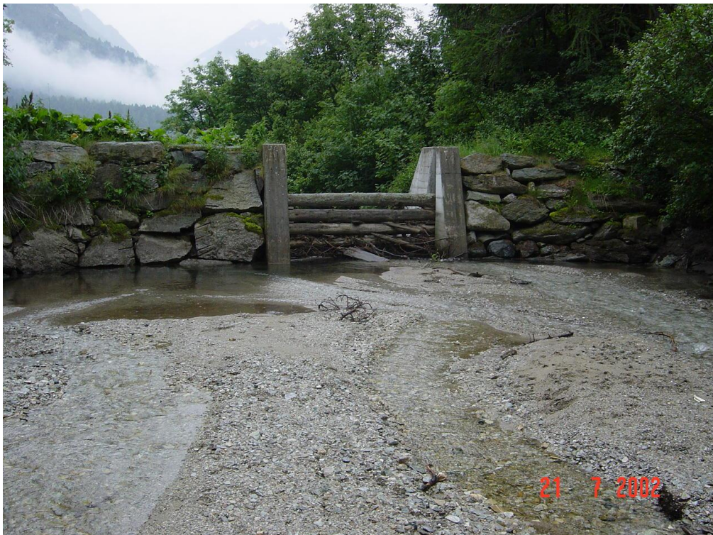
Bild 13. Rückhaltebecken. Ansicht von oben. Das Becken ist gegenwärtig zu mehr als 50% mit Sand und Steinen gefüllt.
