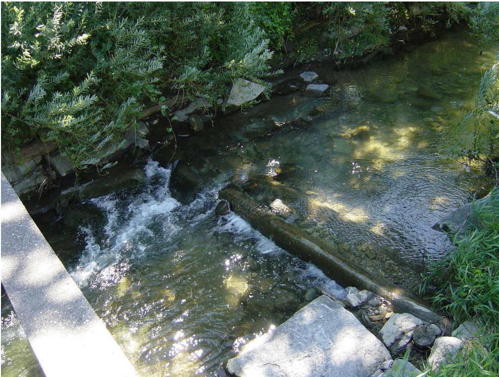
Bild 19. Schwelle aus Holz am Laveggio bei Capolago TI. Grosse Steine Schützen die Schwelle vor einer Unterspülung.
