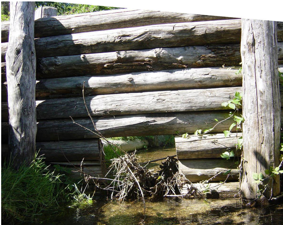
Bild 16. Ein Loch im Holzdammm garantiert das Durchfliessen des Wassers bei normalen Abflussverhältnissen. Beispiel aus dem Tessin.
