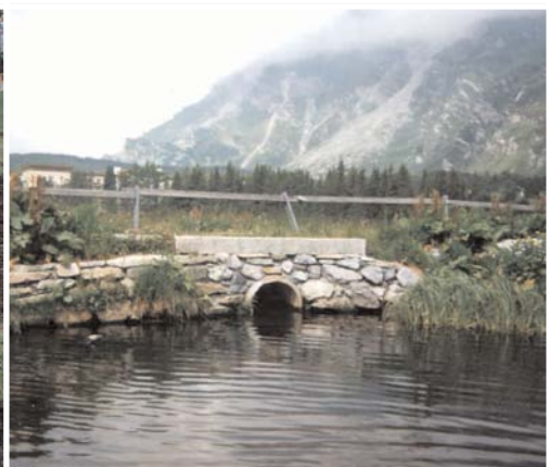
Abb. 2.3-15: Mündungsrohr Aua da la Baselga.
